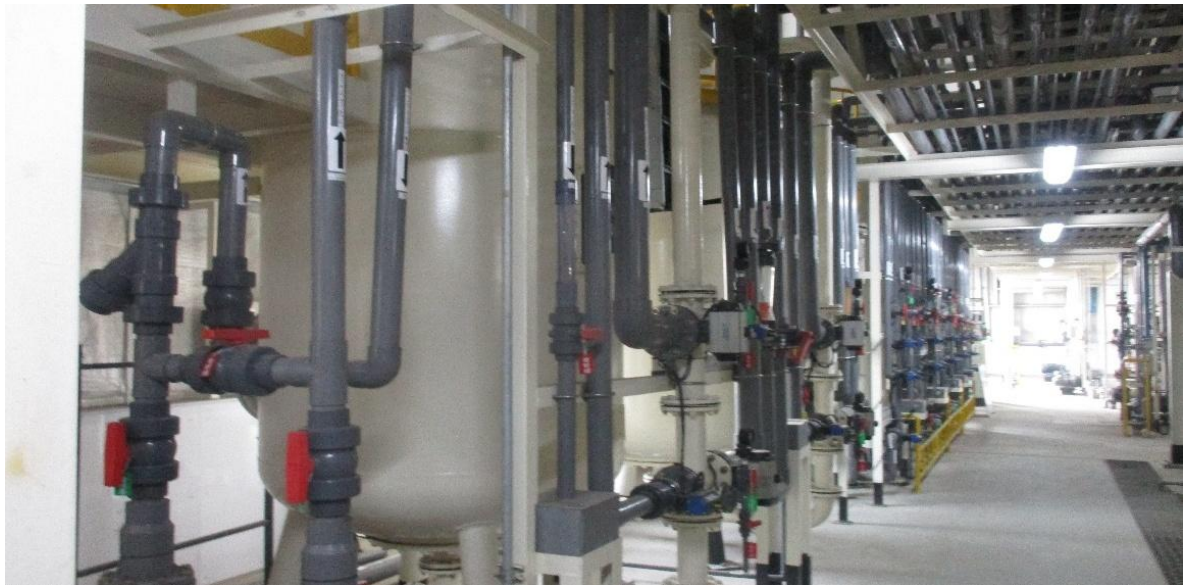
二工厂活性炭装置
