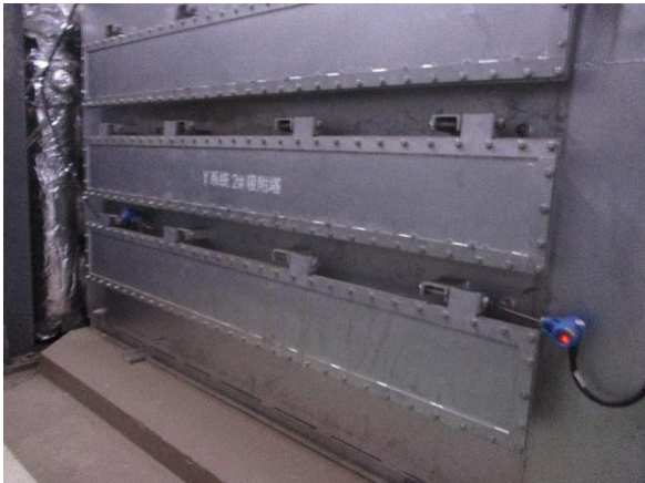
一期沸石吸附装置
