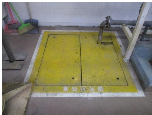
一工厂絮凝沉淀槽
