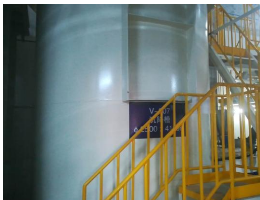
二工厂沉淀槽
