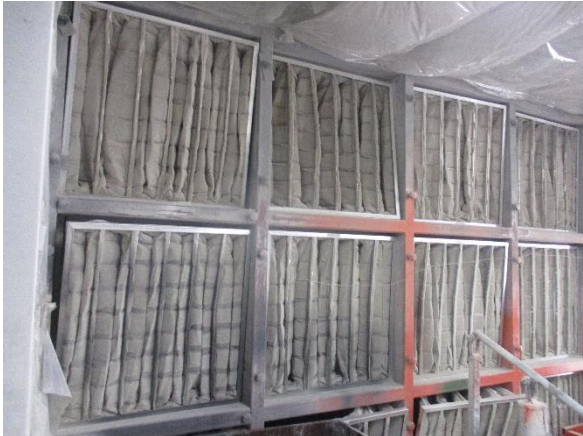
漆雾过滤装置
