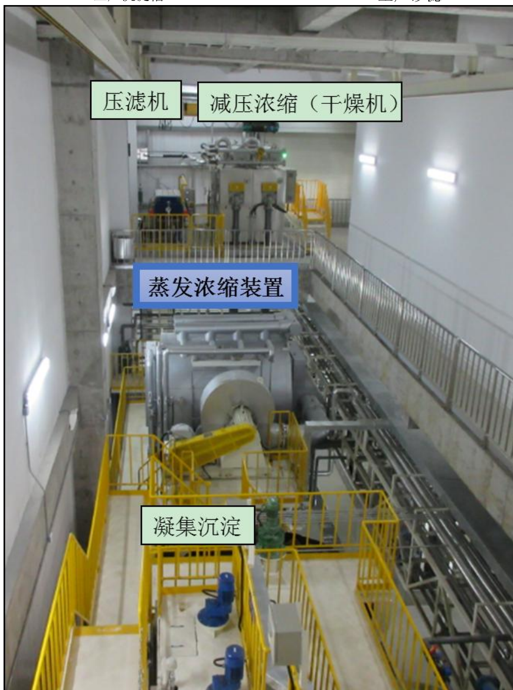
图 4.1-4 废水治理设施图片
